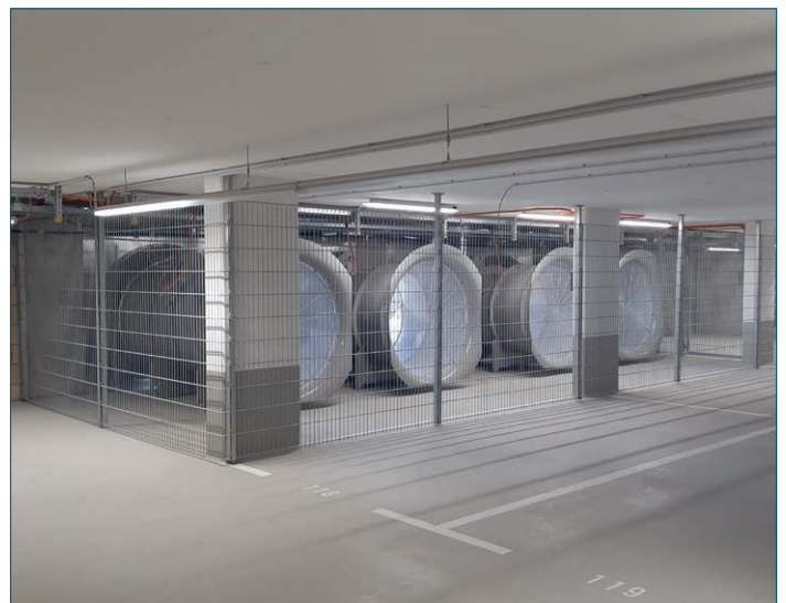
Bild 22: Beispiel der reversiblen Zu- und Abluftventilatoren in einer Großgarage Quelle: TROX X-FANS GmbH
