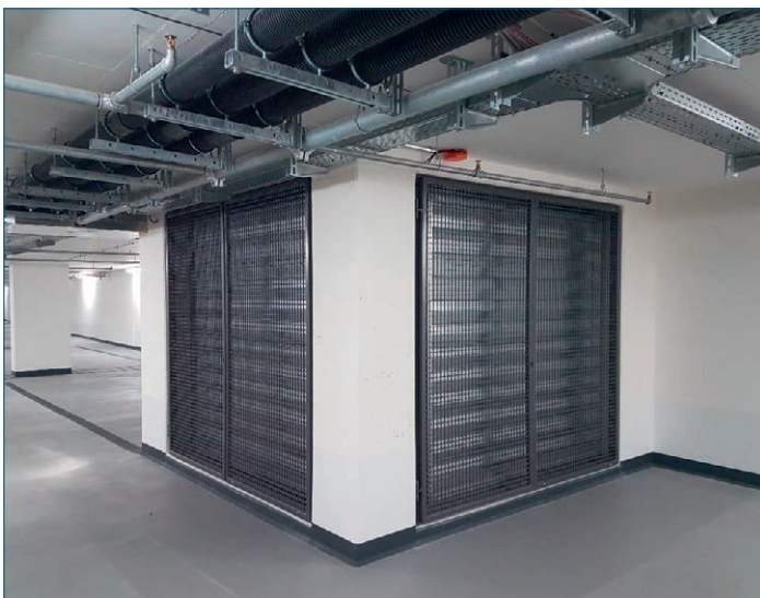
Bild 21: Beispiel der Abluftöffnungen mit Abluftgitter in einer Großgarage Quelle: TROX X-FANS GmbH
