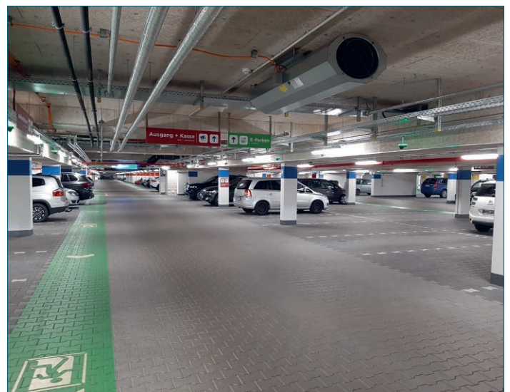
Bild 30: Jet-Ventilatoren unter der Decke einer Tiefgarage Quelle: TROX X-FANS GmbH
